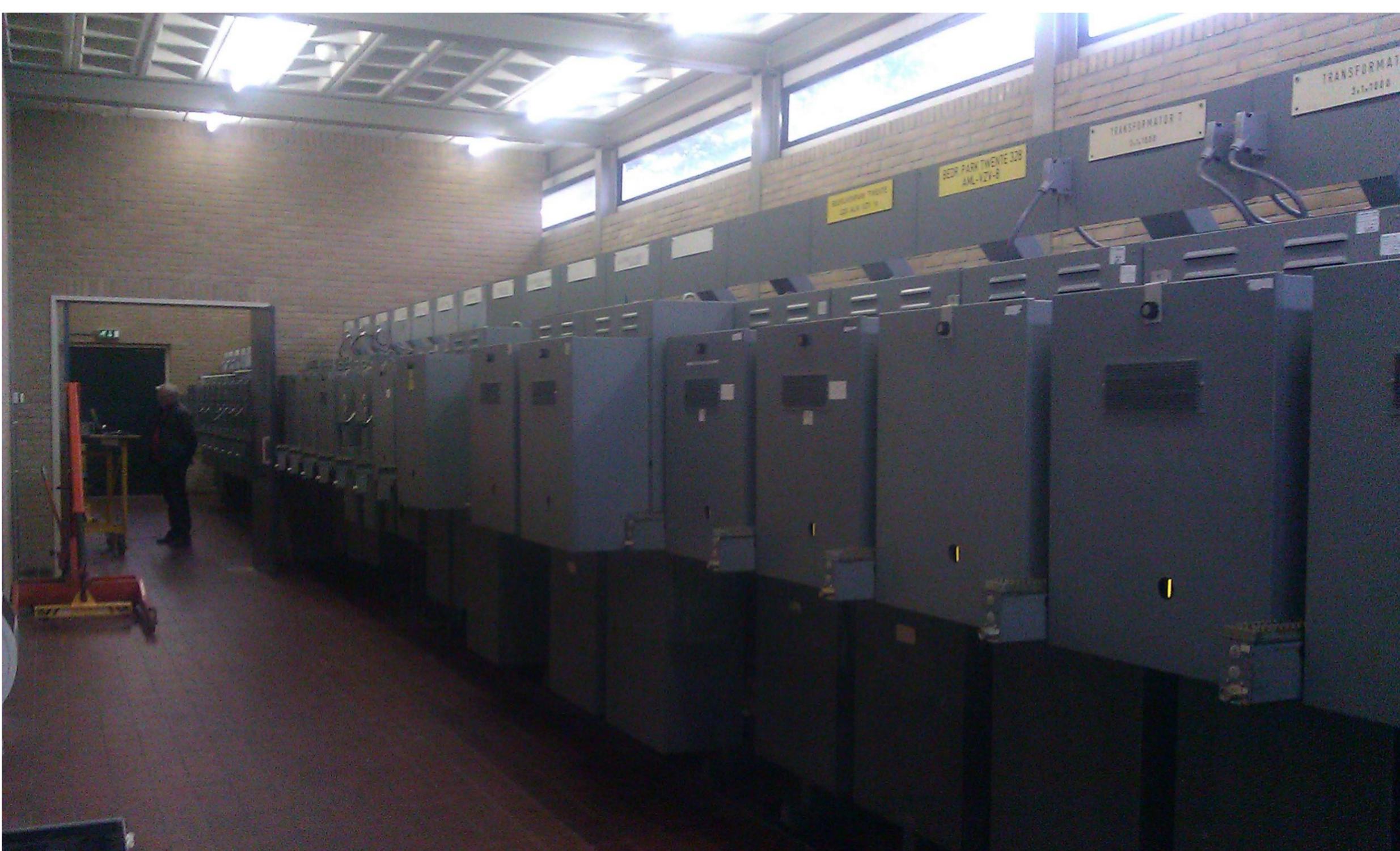
Voorbeeld Reyrolle schakelinstallatie
